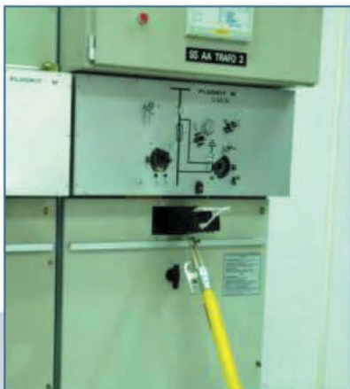
На лицевой панели распределительной ячейки
